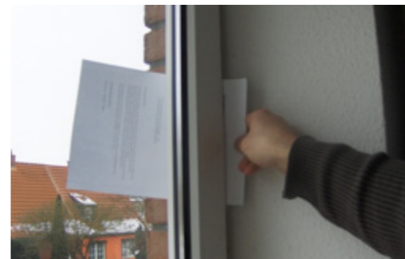
Fenêtre non étanche
